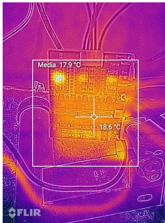
Figura 55. Imagen térmica del BMS.
