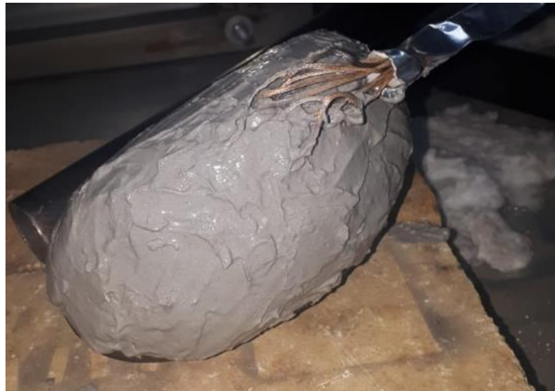
Figura 9 Recubrimiento para protección de termocuplas
