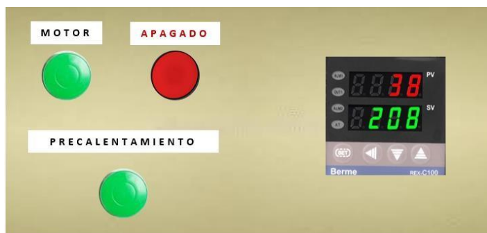
Figura 39 Tablero eléctrico de extrusora.
