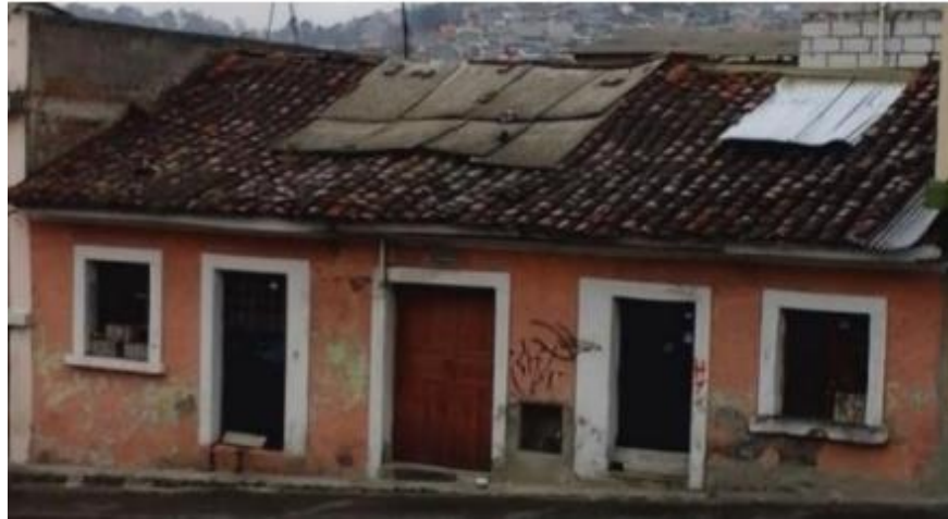
Figura 11: Fotografía de una vivienda residencial con tipología estructural de mampostería sin reforzar unidades desconocidas, no dúctil (Ayala, Sosa, & Chicaiza, 2017)
