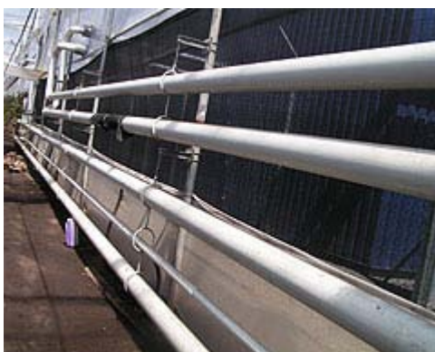
Foto 5: Tuberías de conducción de agua
