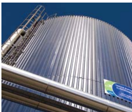
Foto 3: Tanque Buffer para calentar el agua.
