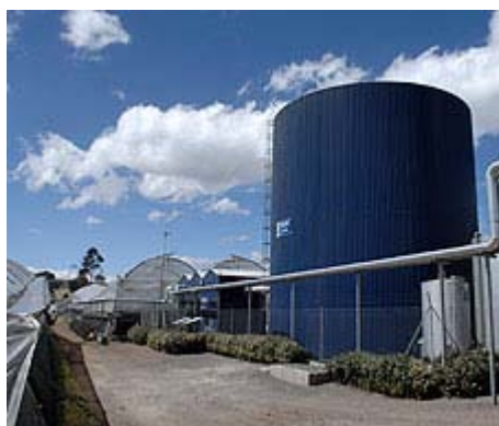
Foto 6: Vista general del sistema calefacción.
