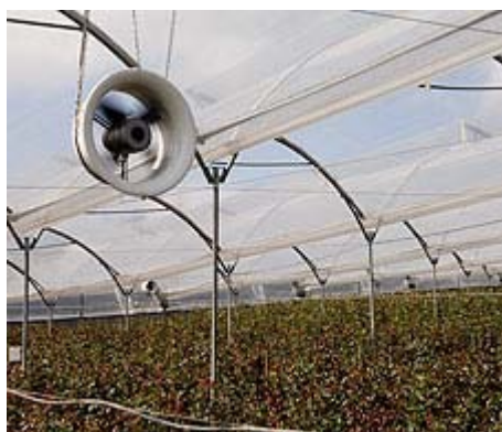
Foto 4: Sistema de ventilación.
