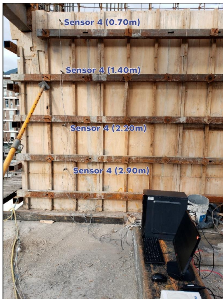
Figura 13: Transductores y sistema de adquisición de datos armado en obra Fuente: Autor
