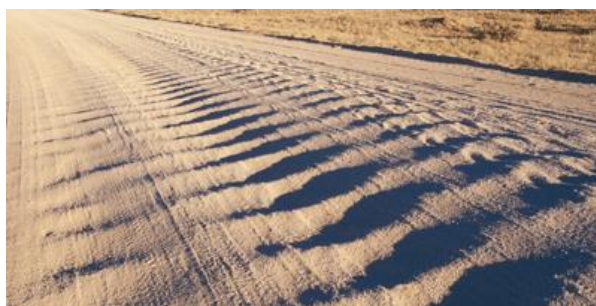
Ilustración 1: Vía no pavimentada con ondulaciones (Physics, 2013)
