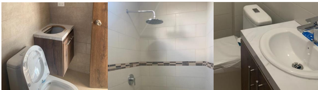
Figura 119 Accesorios y aparatos sanitarios
