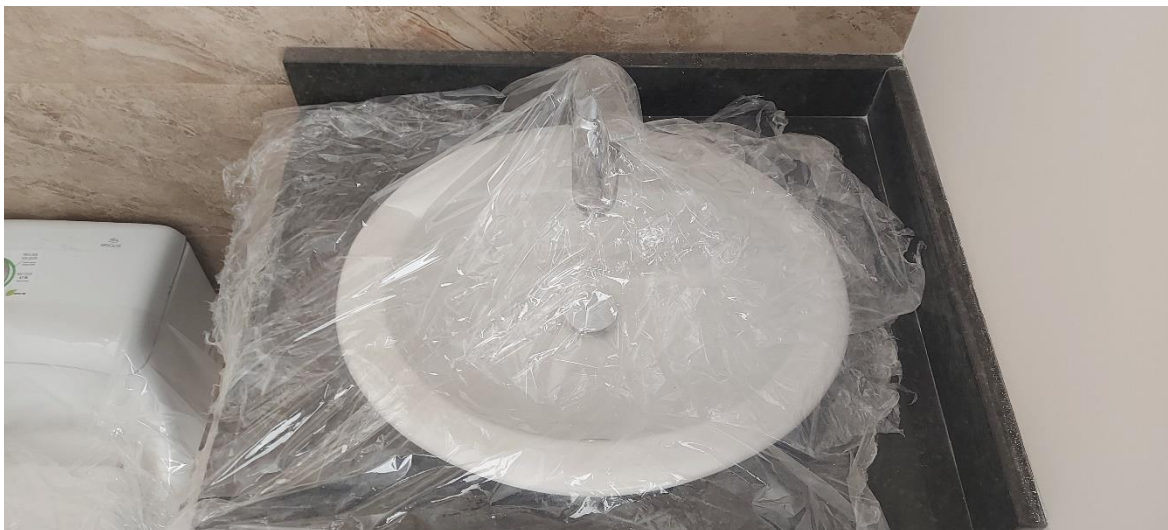
Fotografía 39: Grifería, Lavamanos e Inodoro Autor: Angel Vallejo Salazar
