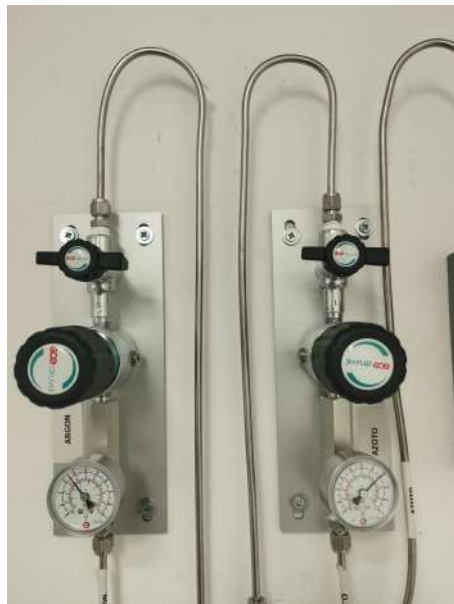
Figure 2.9: En la izquierda se observa la válvula de gas de Argón y a la derecha la válvula de gas de Nitrógeno
