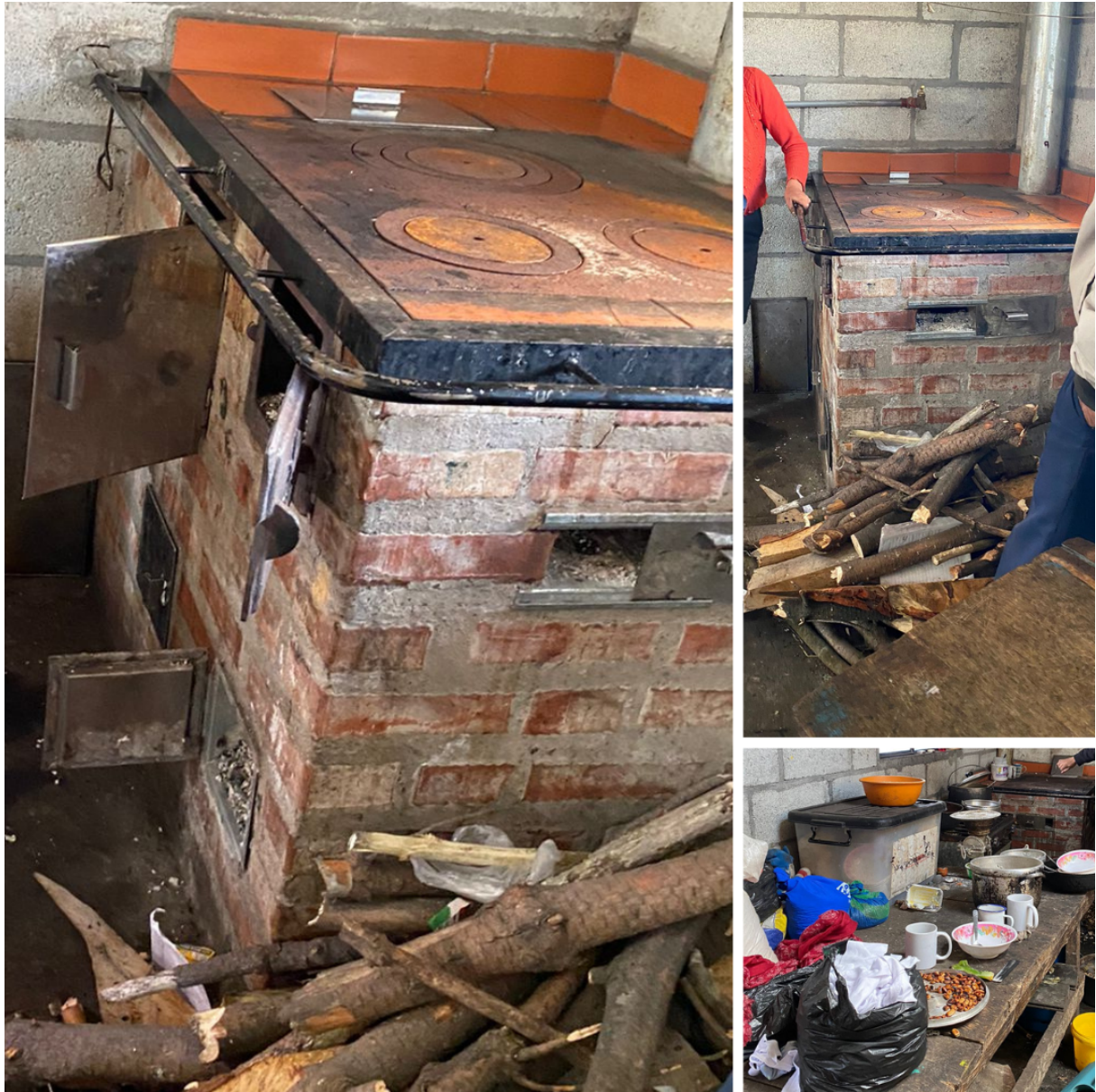
Figura 6. Cocina mejorada con chimenea exterior.
