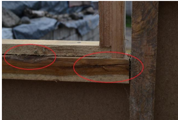
Figura 15: Arista faltante y grieta
