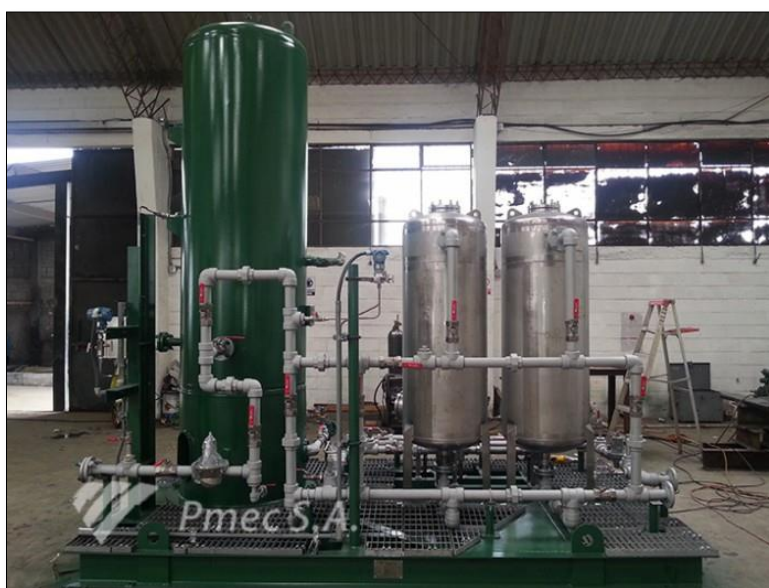
Foto 1: Skid de agua de utilidades. Fuente: Pmec S.A. (2014)
