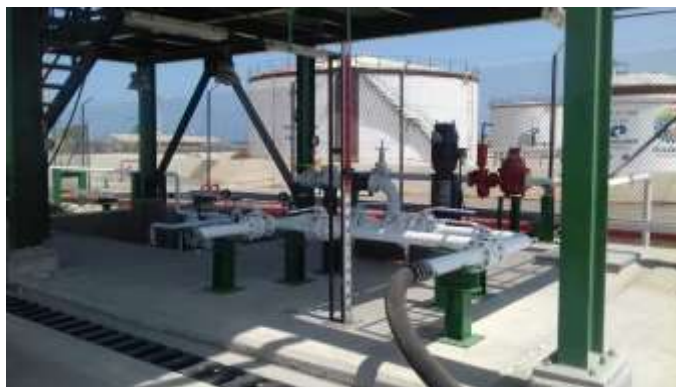
Figura 13 Bomba vertical en la cisterna, bomba 4x3x12.
