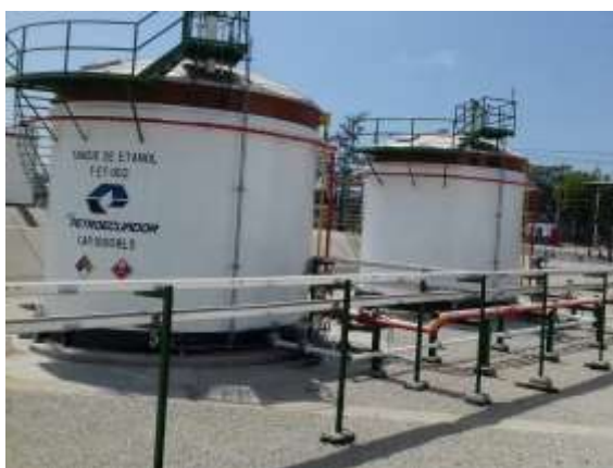
Figura 16. Tanques de etanol.
