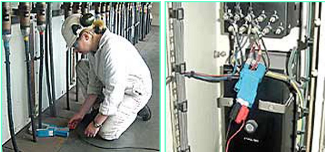
Figura 2.8. Medición de Corriente usando pinzas amperimétricas.
