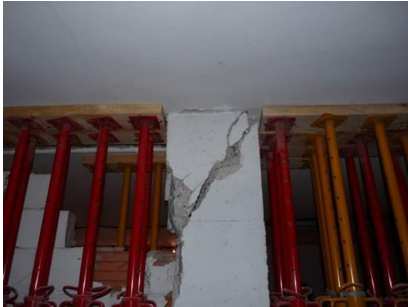
Figura No.2: Fallo de Pilar en Puerto Quito en el 2016 por mal encofrado.
