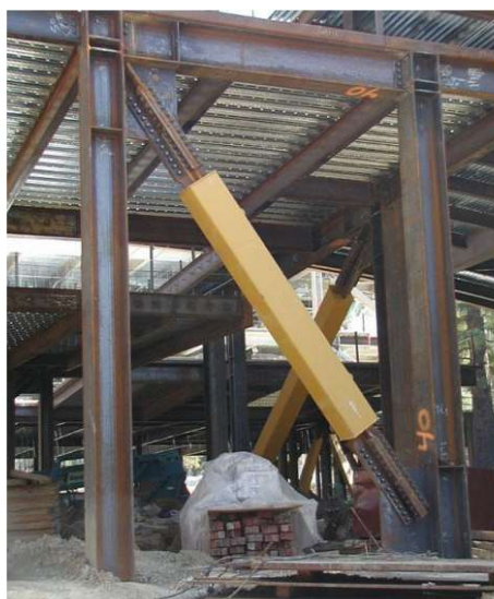
Ilustración 6. Vista de una riostra de pandeo restringido en un edificio de la Universidad de California, Berkeley. Referencia: Crisafulli 2014.
