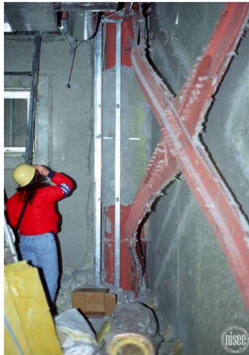
Ilustración 2. Pandeo de una riostra, terremoto de hyogoken Nabu, Japon (Cortesía de National Information Service for Earthquake Enginnering, EERC, University of California, Berkeley), Crisafulli, 2014
