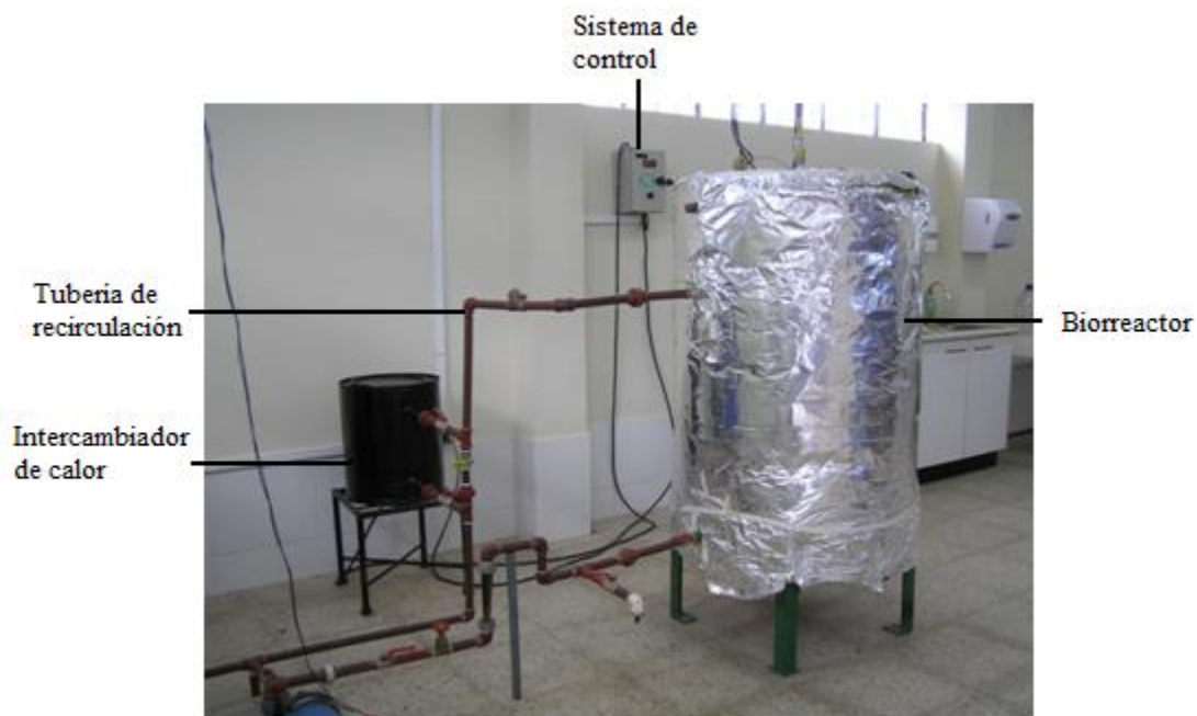
Figura 5.8: Intercambiador de calor conectado al sistema de recirculación del biorreactor
