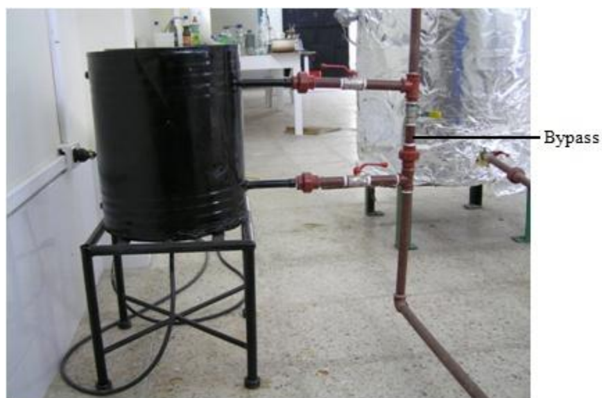
Figura 5.9: Intercambiador de calor conectado al sistema de recirculación y bypass
