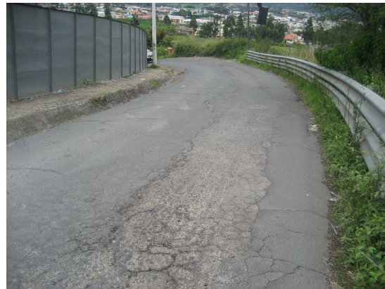
Imágenes. 3.4.5. El mal estado de las Vías
