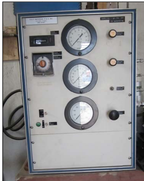
Figura 2.5 Panel de control de válvulas de presión
