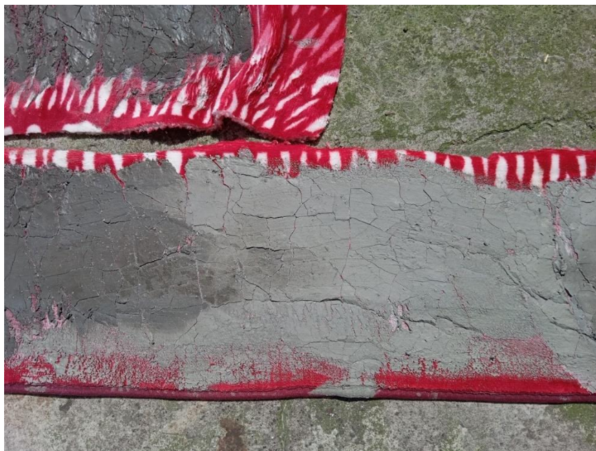
Figura 29. Detalle de fractura en el cemento.
