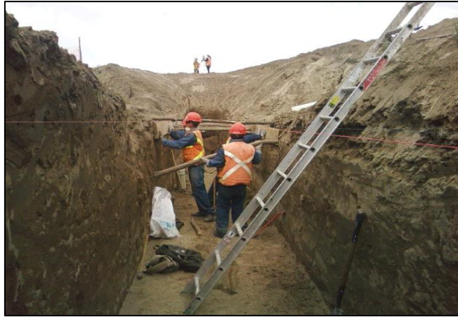
Fotografía No. 23 Uso de escalera al interior de zanja Fuente: Propia
