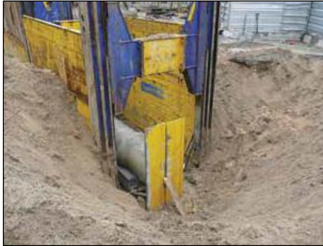
Fotografía No. 21 Sistema de apuntalamiento con Guías y Planchas Verticales Fuente: Seguridad en los Trabajos en Zanjas – OSALAN 2012
