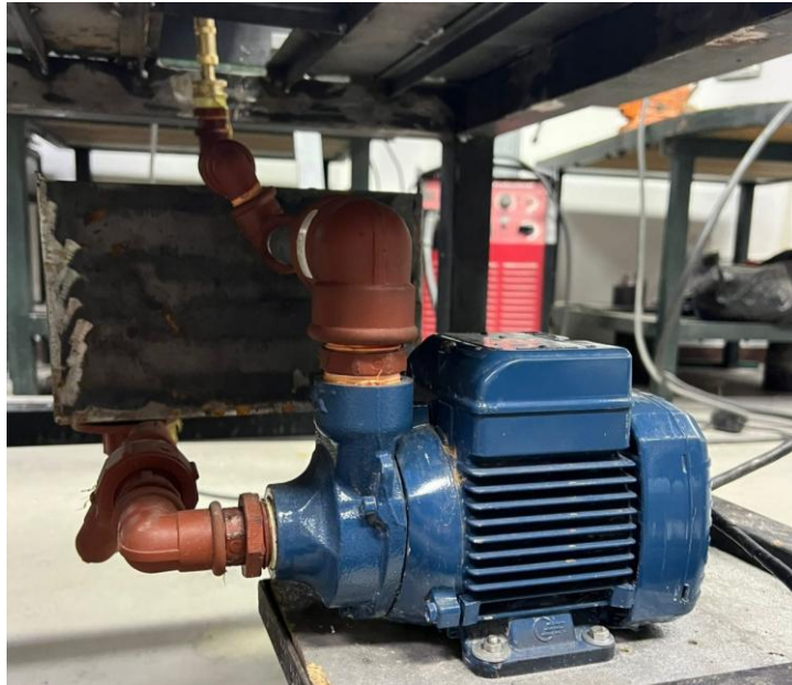
Figura #31. Sistema de enfriamiento
