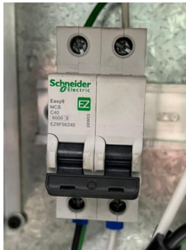
Manual de operación figura #13. Interruptor termomagnético encendido
