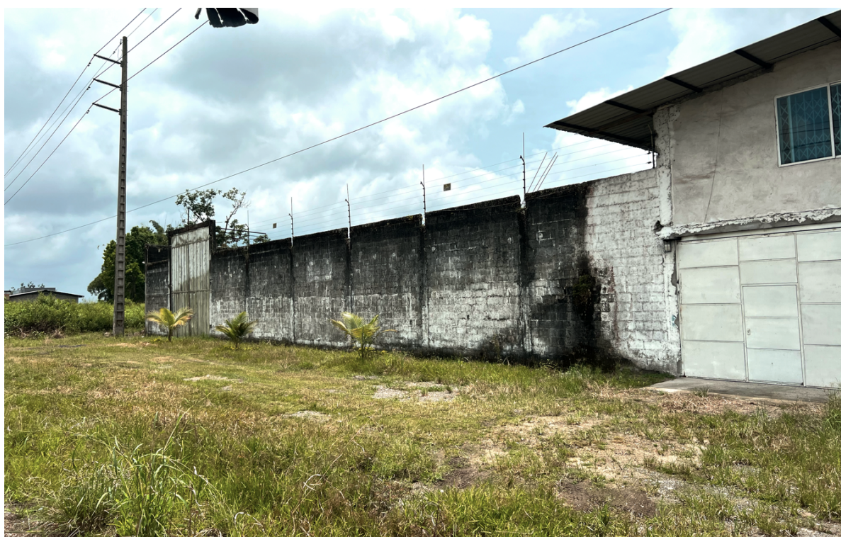
Ilustración 20 Estado de Aceras Fotografiado por: Jean Torrico
