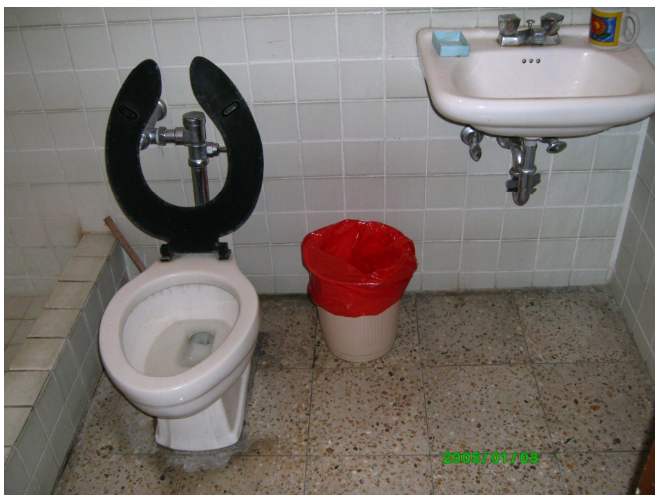
Fotografía 46: Recipiente para desechos comunes, con la funda inadecuada
