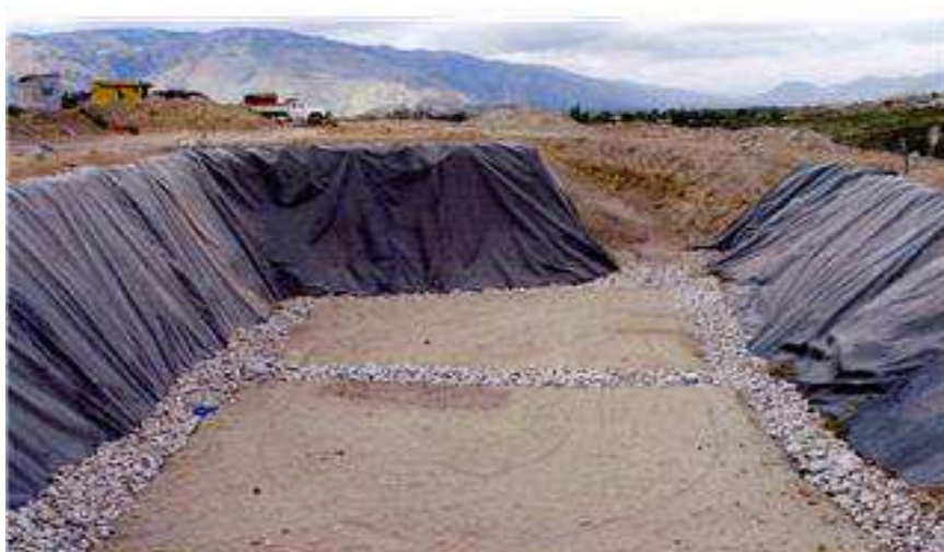
Fotografías No. 43 148 : avance de la construcción del relleno sanitario de la ciudad de Ibarra en enero de 2008
