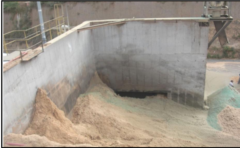
Ilustración 5. Bunker de almacenamiento de aserrín y viruta.
