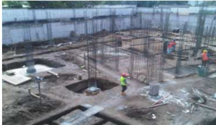
Ilustración 5-12 Vista del terreno al momento de la cimentación.- Fuente: Edwin Samaniego Arquitectos.
