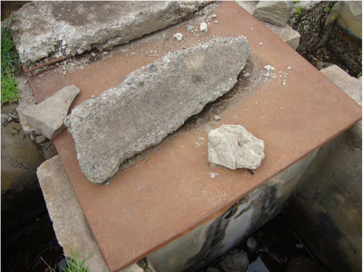
a.- Módulos en mal estado
