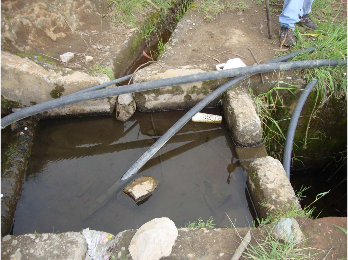
c.- Falta de mantenimiento en los módulos
