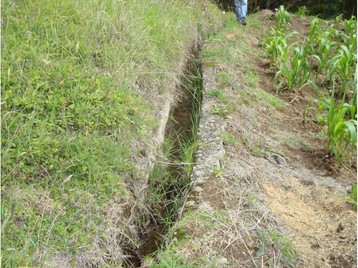
b.- Conducciones terciarias en mal estado
