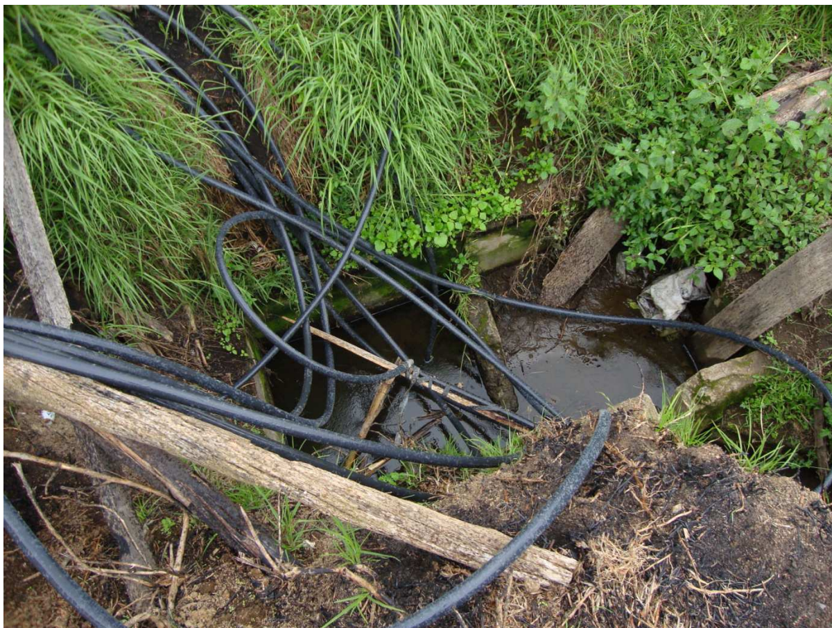
d.- Mangueras que obstaculizan el paso del agua
