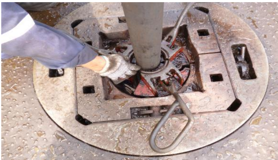
Imagen No. 7 Manos en riesgo en cuñas Fuente: Autor
