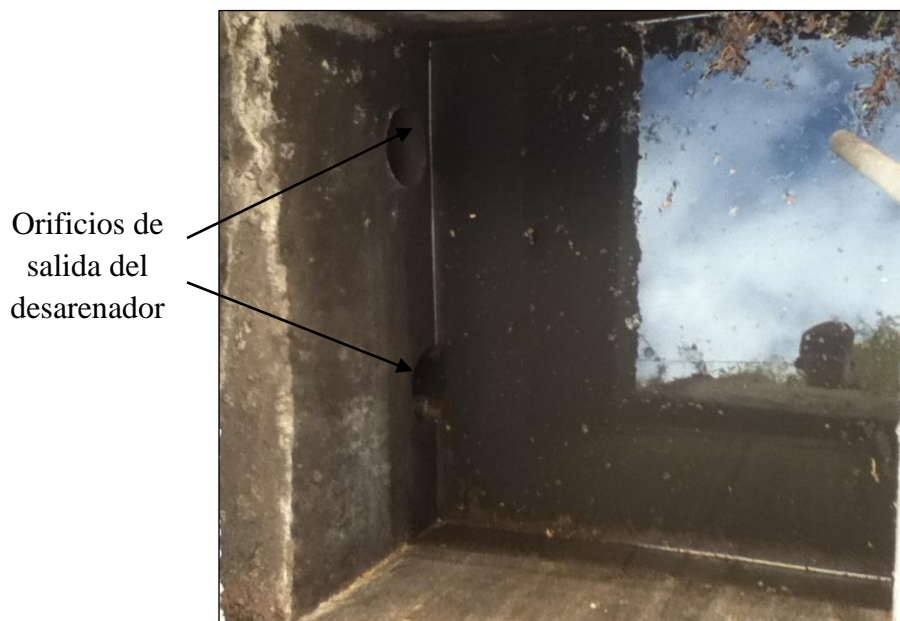
Figura 4.15: Salida de agua del desarenador
