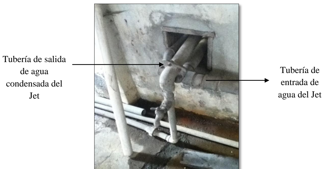
Figura 4.7: Tuberías de entrada y salida del jet
