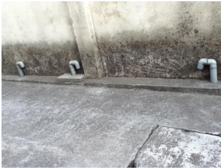
Figura 4.16: Tubos aireadores de la piscina
