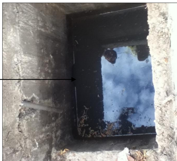
Figura 4.14: Tubería de salida del desarenador
