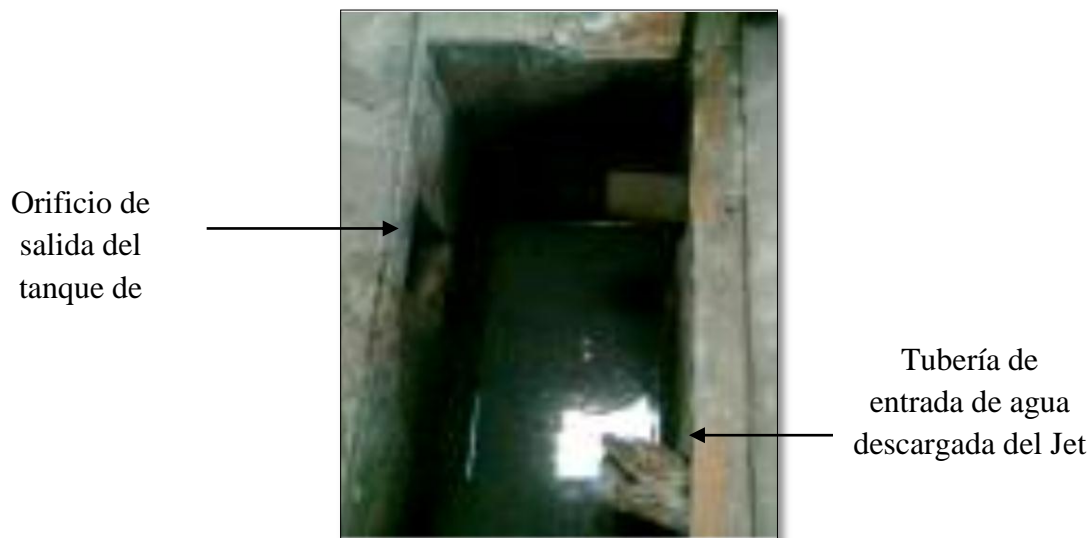
Figura 4.8: Tanque de revisión
