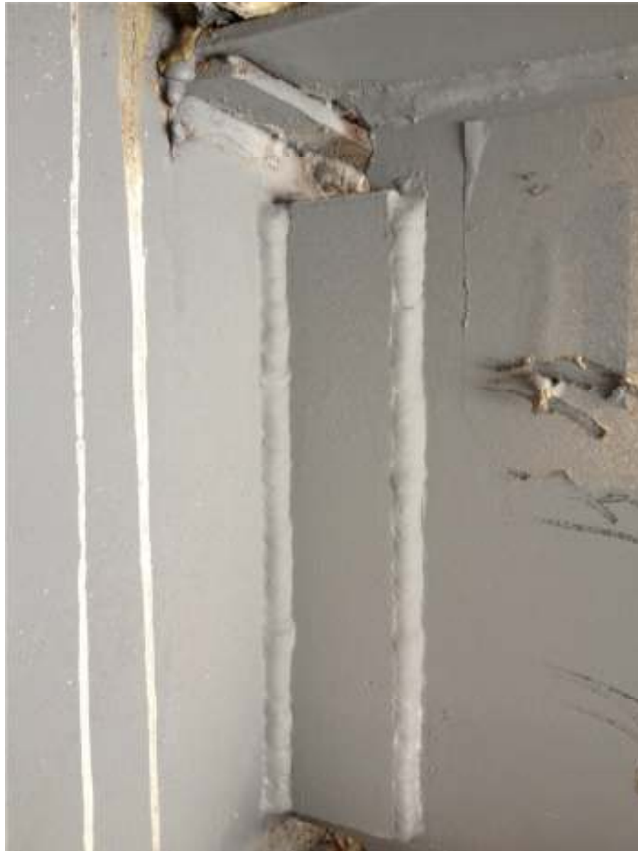
Figura 30. Procesos de soldaduras incorrectos en cordón de patín superior
