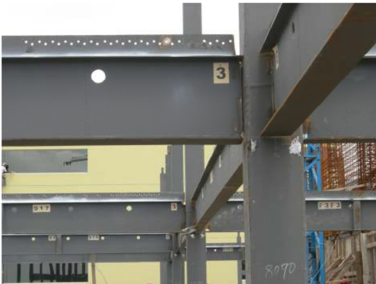
Figura 31. Malas prácticas en montaje y diseño de conexiones viga-columna
