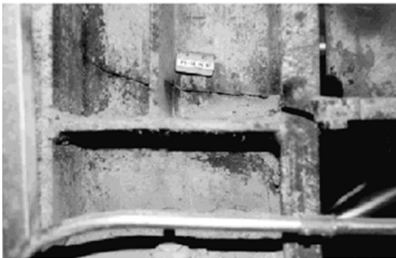
Figura 10. Fractura de una columna en una estructura de Los Ángeles en el sismo de Northridge (FEMA 350, 2000)
