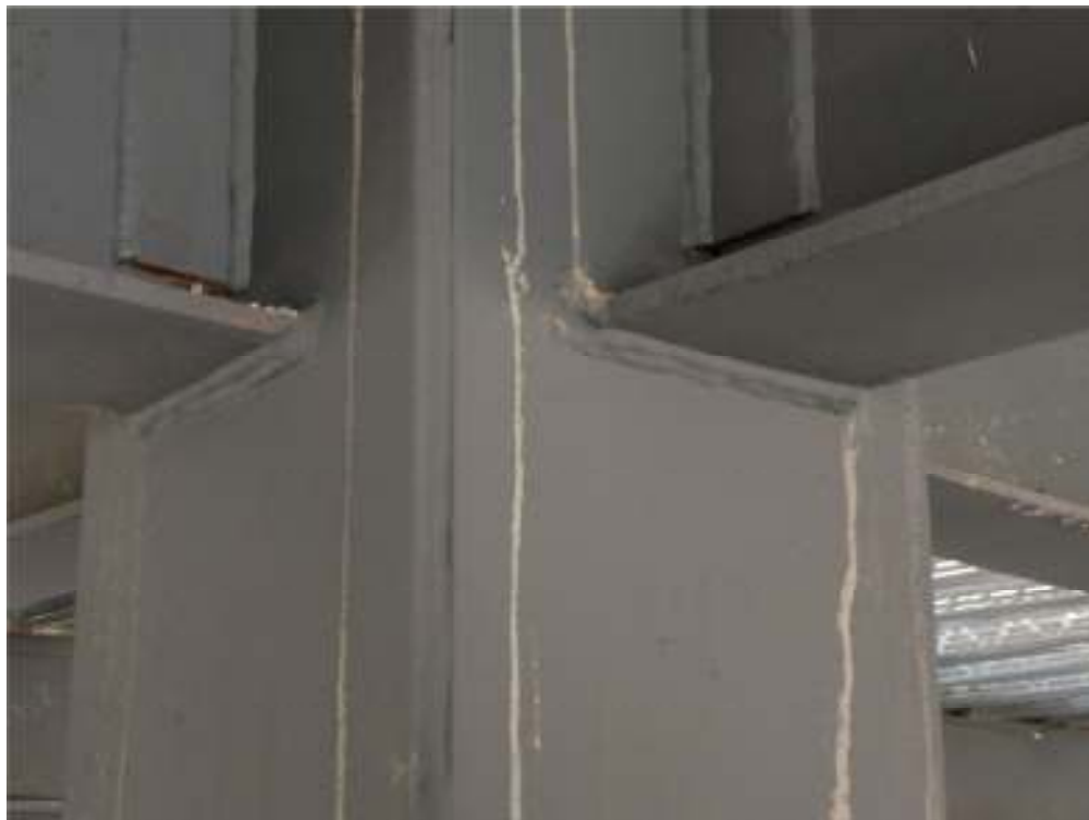
Figura 29. Cordón de soldadura en patín inferior de edificio en construcción de Empresa 1
