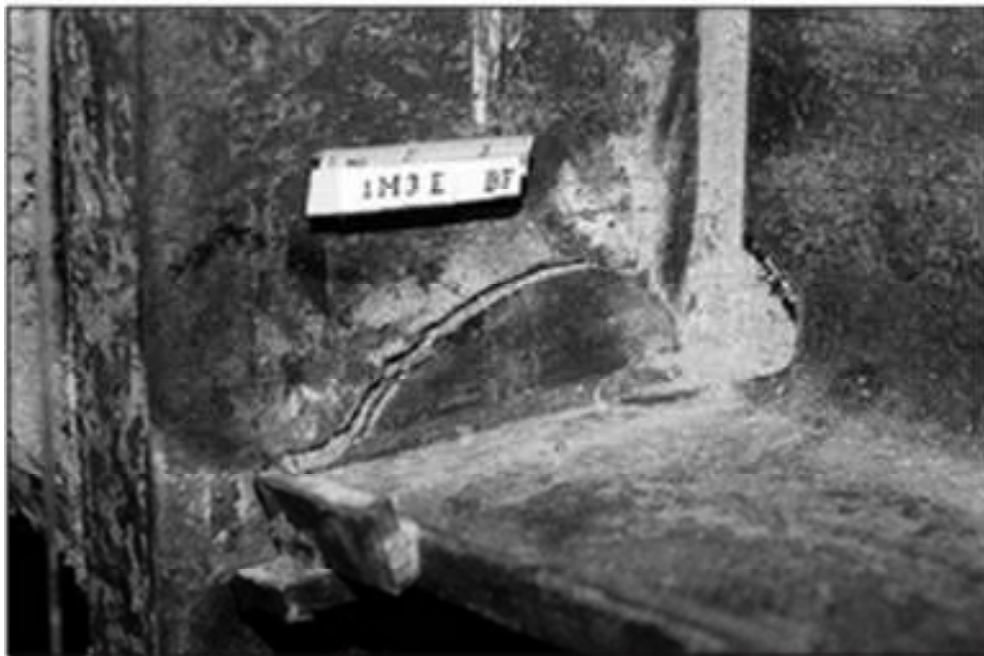
Figura 24. Fractura que dio como resultado una gran grieta desde el patín de la viga a la columna. (Alacero, 2008)
