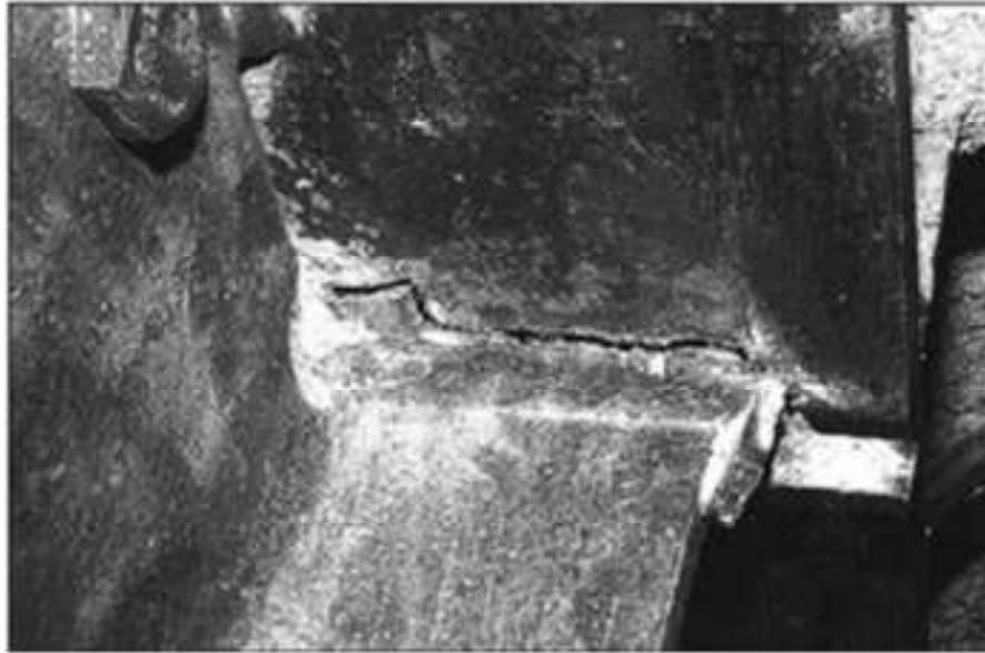
Figura 23. Falla frágil separando el patín de la viga de la columna. (Alacero, 2008)
