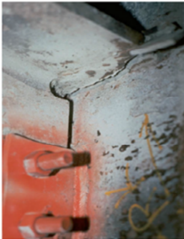
Figura 5. Fractura de soldadura en conexión viga-columna en un PEARM (FEMA 350, 2000)
