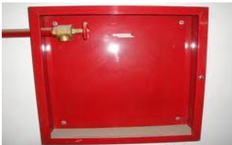
Ilustración 10, Toma de agua 24
