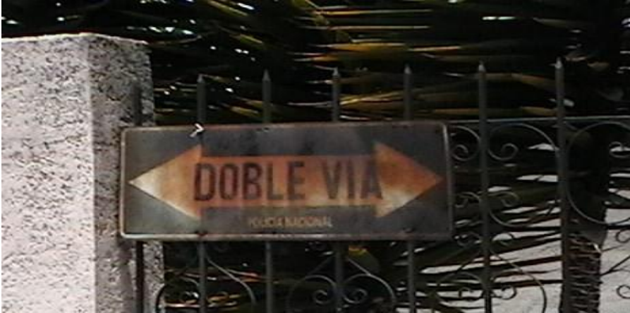
Ilustración 40 Señal Vertical deteriorada e ilegible ubicada en la calle Félix Valencia y Av. Amazonas.
