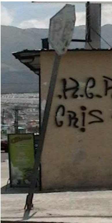
Ilustración 41 Señal Vertical deteriorada e ilegible ubicada en la calles Quito y Juan Abel Echeverría
