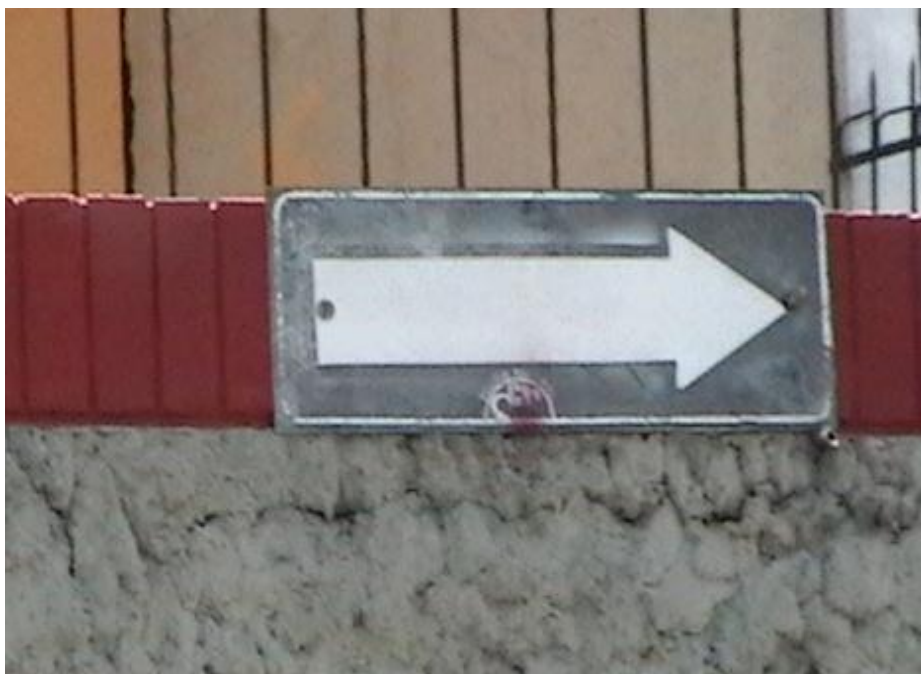
Ilustración 9, señalización vertical deteriorada
