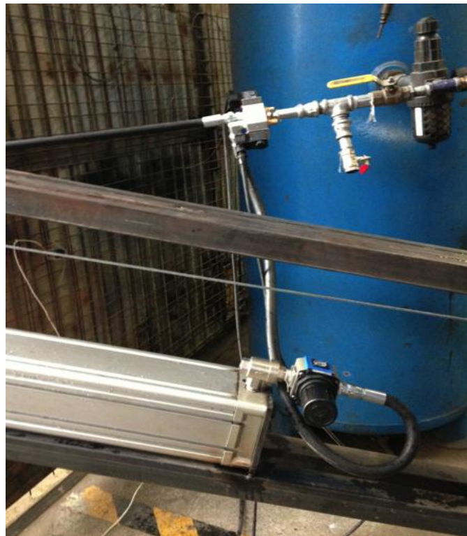
Figura 48.- Instalación Neumática del Sistema de Lanzamiento
