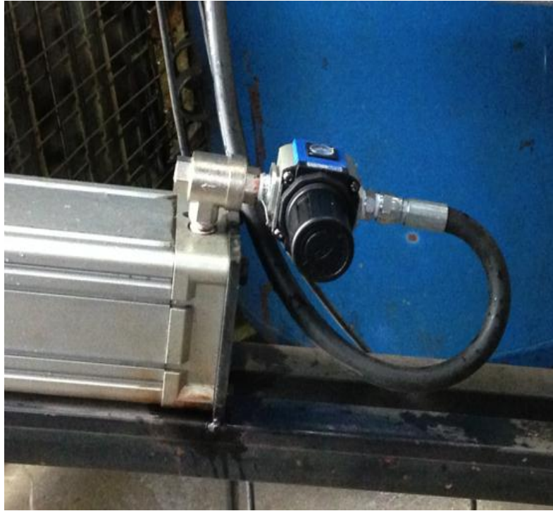
Figura 47.- Sistema de regulación de flujo y presión instalado a la salida del escape rápido.
