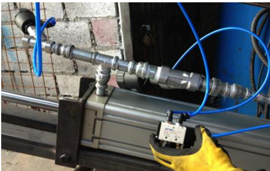
Figura 46.- Electroválvula que activa y desactiva el sistema de válvulas angulares.
