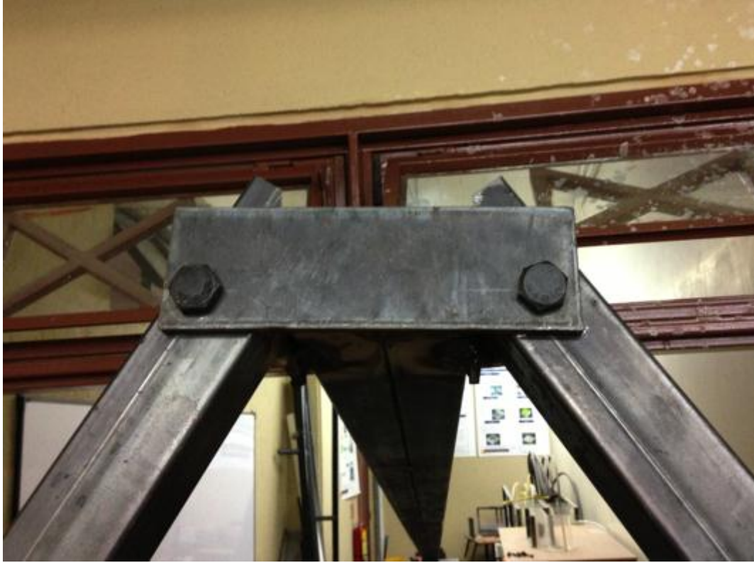
Figura 36.- Platina soldada a la pista de la plataforma y empernada a los soportes principales de ésta.
