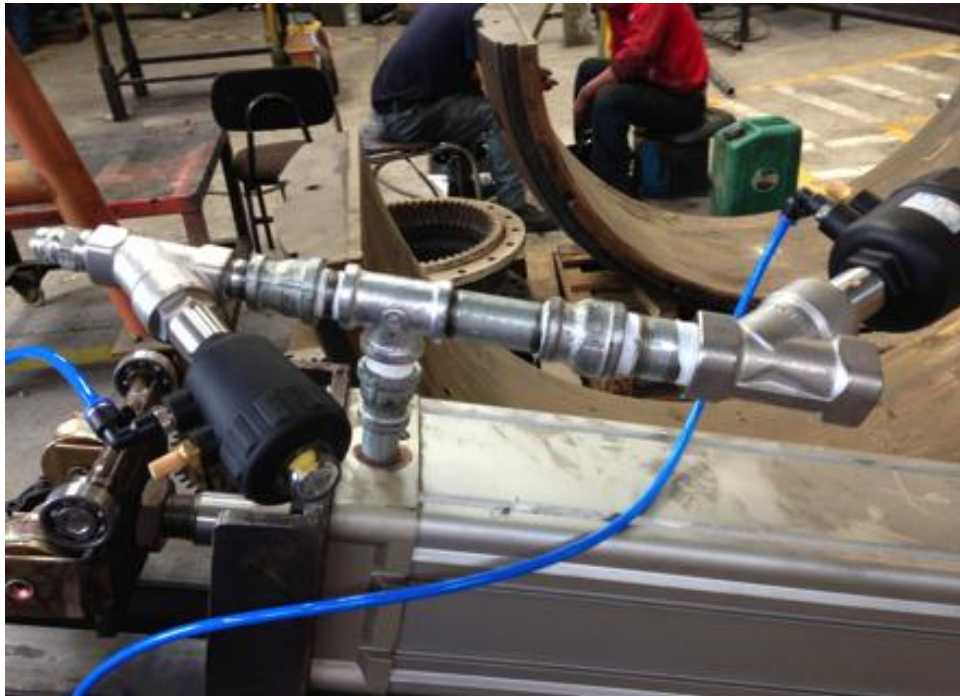
Figura 45.- Sistema de válvulas angulares.
