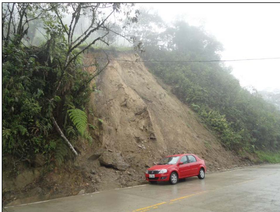
Fotografía No. 7: Detalle de talud inestable afectado por caída de tierra y escombros. El material aflorante pertenece a la Unidad Gneis de Sabanilla. UTM: 719958-9561814
