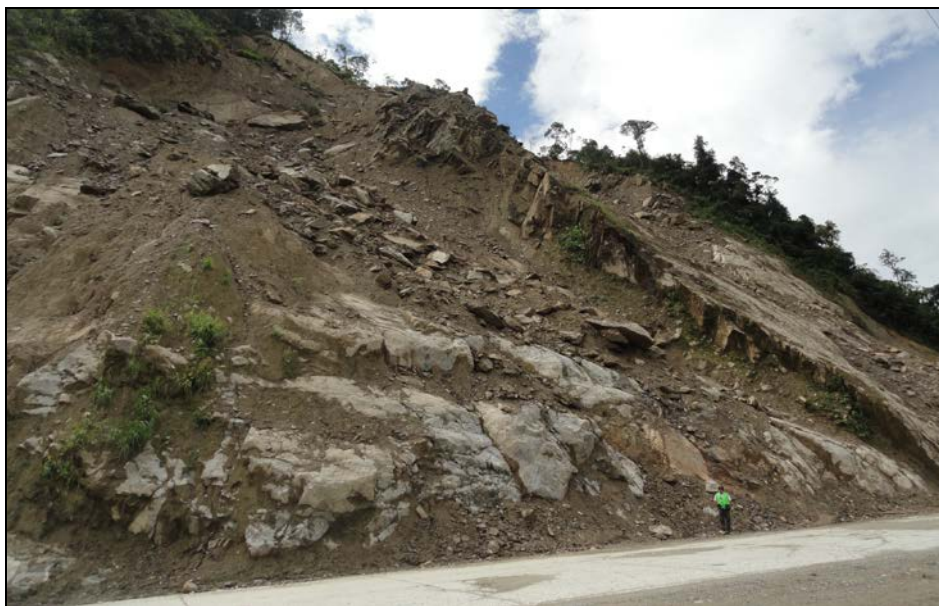
Fotografía No. 5: Detalle de deslizamiento planar a un costado de la vía. El material aflorante pertenece a la Formación Chigüinda. UTM: 716835-9562764
