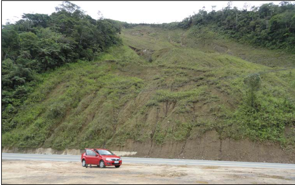
Fotografía No. 9: Detalle de ladera afectada por caída de tierra y localmente flujos de detritos. El material aflorante pertenece a la Unidad Metamórficos indiferenciados. UTM: 725502-9551458
