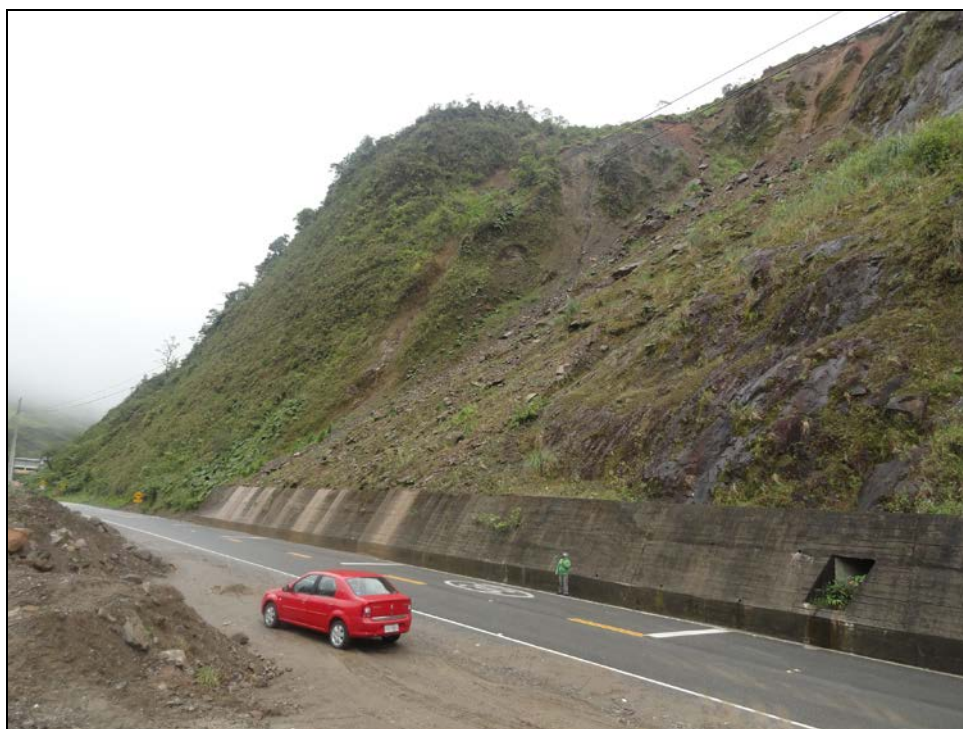
Fotografía No. 6: Detalle flujos de detritos y avalanchas de escombros a un costado de la vía. El material aflorante pertenece a la Formación Chigüinda. UTM: 716014-9561614
