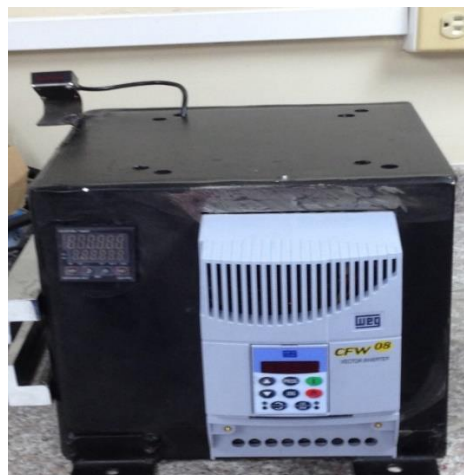
Figura 11: Sensor láser, contador digital y variador de frecuencia correctamente instalados
