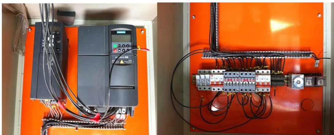
Ilustración 51: Tablero de Control
