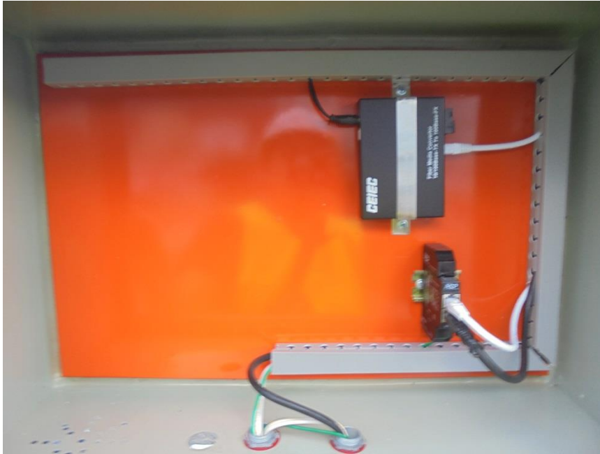
Figura 25 Alimentación eléctrica conversor de Ethernet a Fibra
