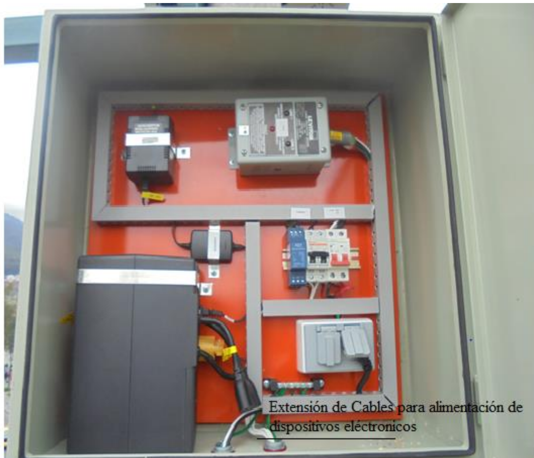
Figura 23 Extensión de cables para Alimentación Eléctrica de Dispositivos Electrónicos.
