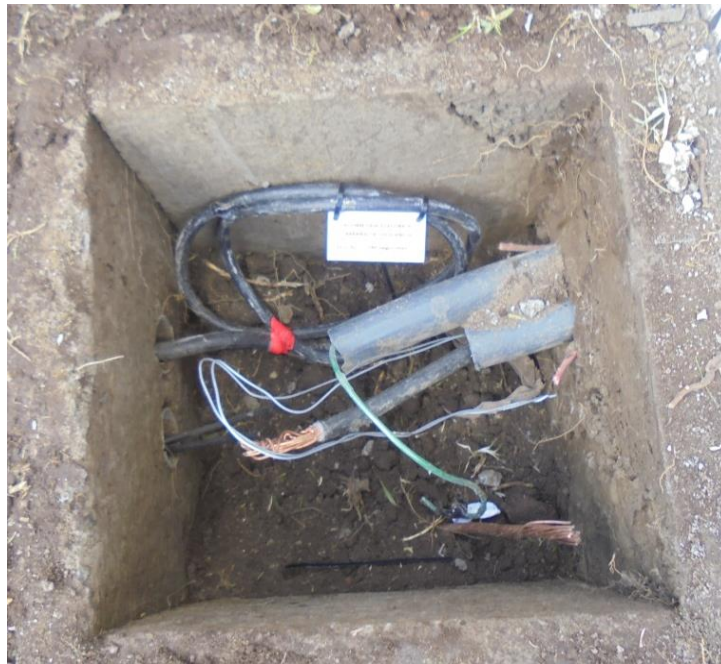
Figura 1 Punto de Acometida Eléctrica 110V AC
