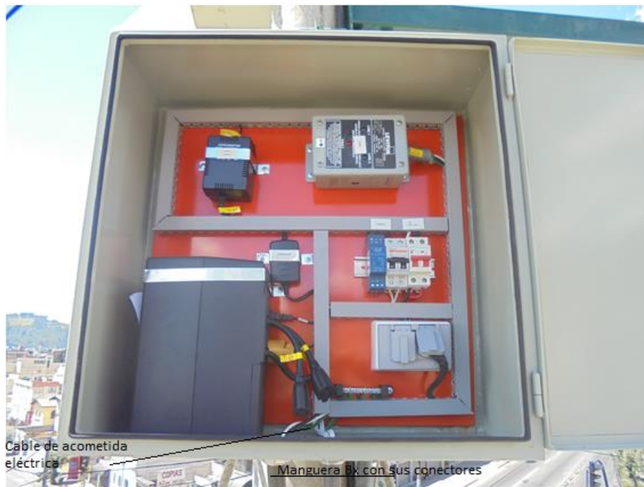
Figura 21 Ingreso a Caja Eléctrica de Acometida por medio de manguera Bx de \frac{3}{4} .
