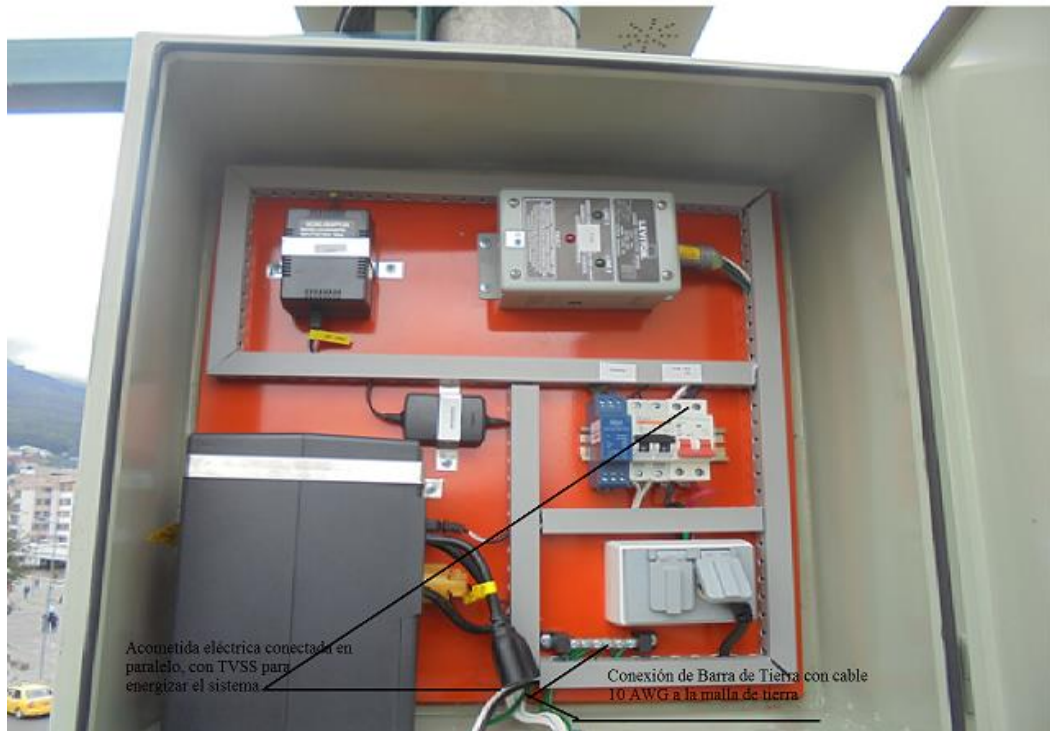
Figura 22 Energización del Sistema de alimentación y protección.
