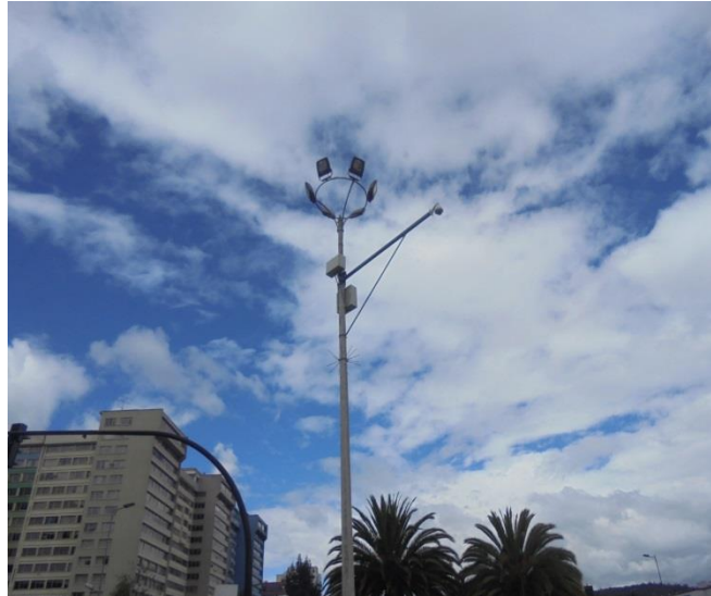
Figura 20 Caja Eléctrica colocada en el poste antes de realizar conexiones.
