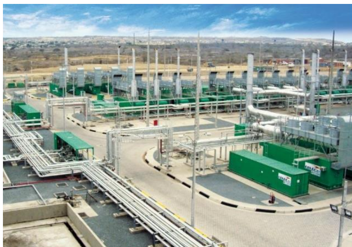
Figura 19 Central Termoelectrica Santa Elena II Fuente: Electroguayas (2013)
