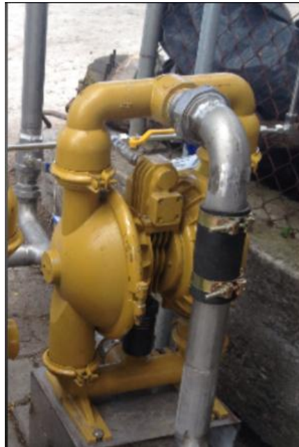
Figura 6.4 Bomba B-4 con su sistema de amortiguamiento
