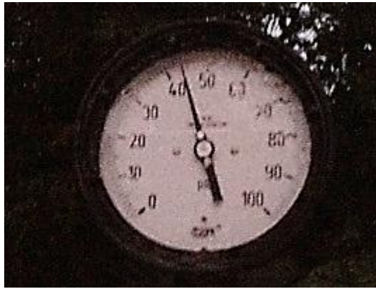
Figura 6.3 Manómetro del tanque C-3
