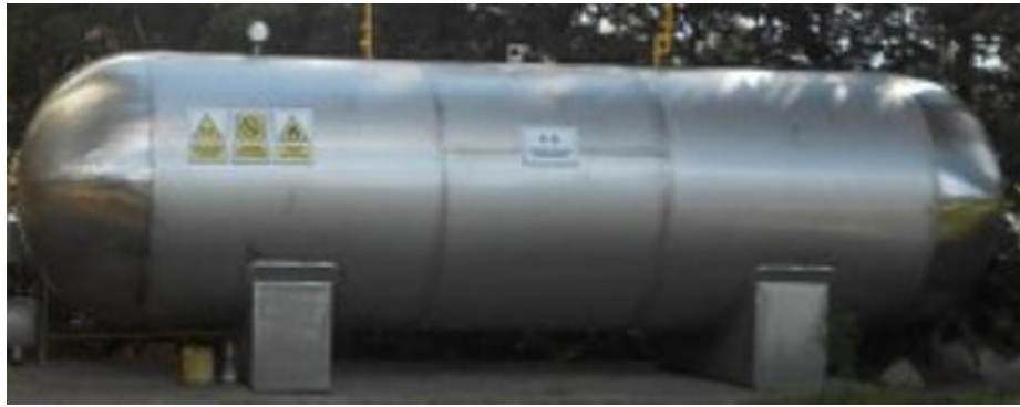
Figura 5.12 Tanque de almacenamiento de biogás comprimido C-3
