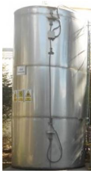
Figura 5.11 Tanque de almacenamiento de biogás C-2
