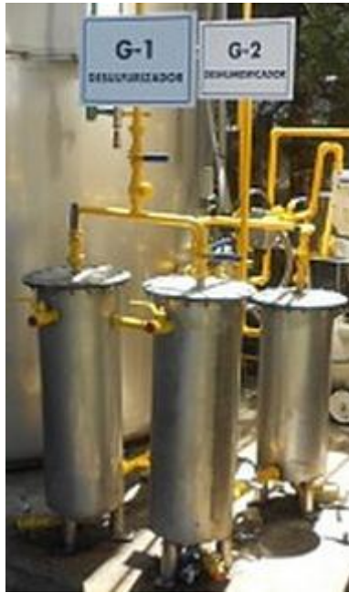
Figura 5.10 Desulfurizador de biogás G-1 y Deshumidificador de biogás G-2
