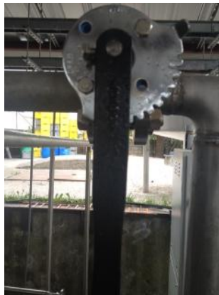
Figura 6.8 Válvula de mariposa a la salida del tanque homogenizador A-1
