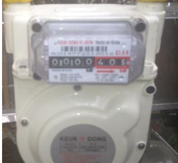
Figura 6.2 Contador de gas
