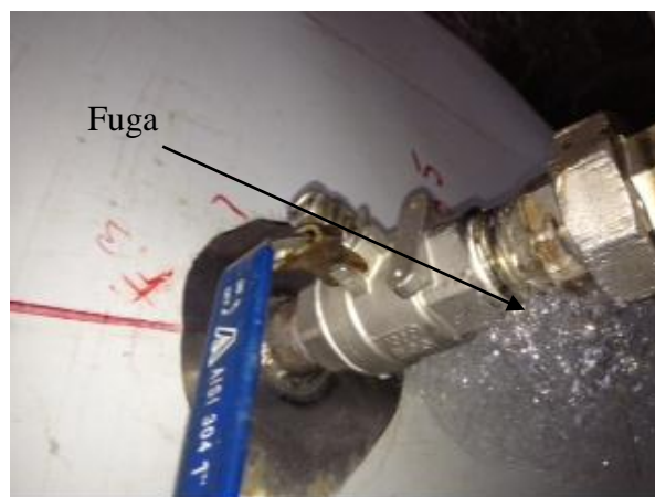
Figura 6.5 Fuga alrededor del anillo perimetral
