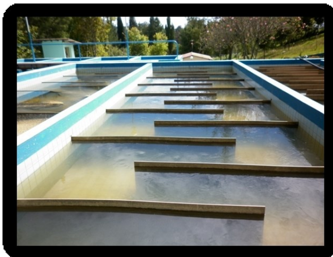
Ilustración 4. Proceso de Potabilización, Piscinas de Floculación Sistema de Agua Potable Patamarca Tomada 16/08/2013
