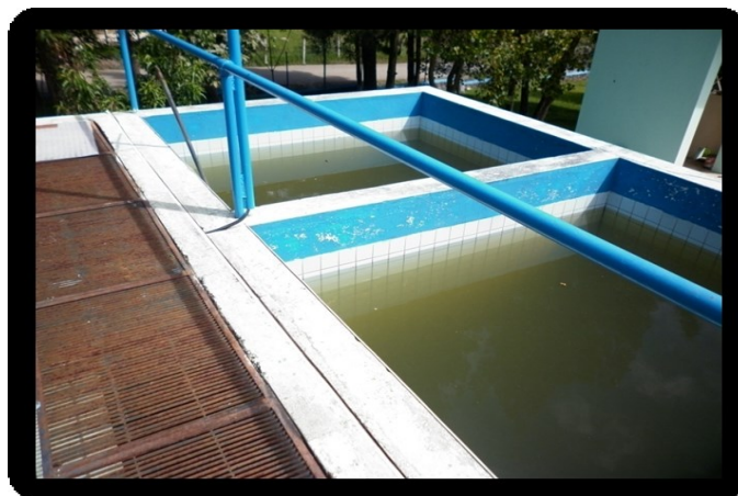
Ilustración 6. Proceso de Potabilización, Filtros, Sistema de Agua Potable Patamarca Tomada 16/08/2013
