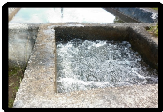
Ilustración 1. Proceso de Potabilización, Tanque de Captación, Sistema de Agua Potable Patamarca Tomada 16/08/2013
