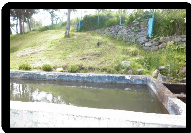
Ilustración 2. Proceso de Potabilización, Presedimentador, Sistema de Agua Potable Patamarca Tomada 16/08/2013
