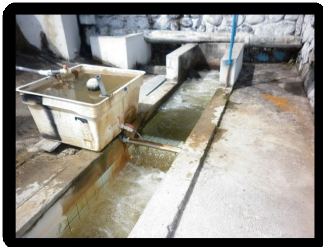
Ilustración 3. Proceso de Potabilización, Canal conductor, Sistema de Agua Potable Patamarca Tomada 16/08/2013
