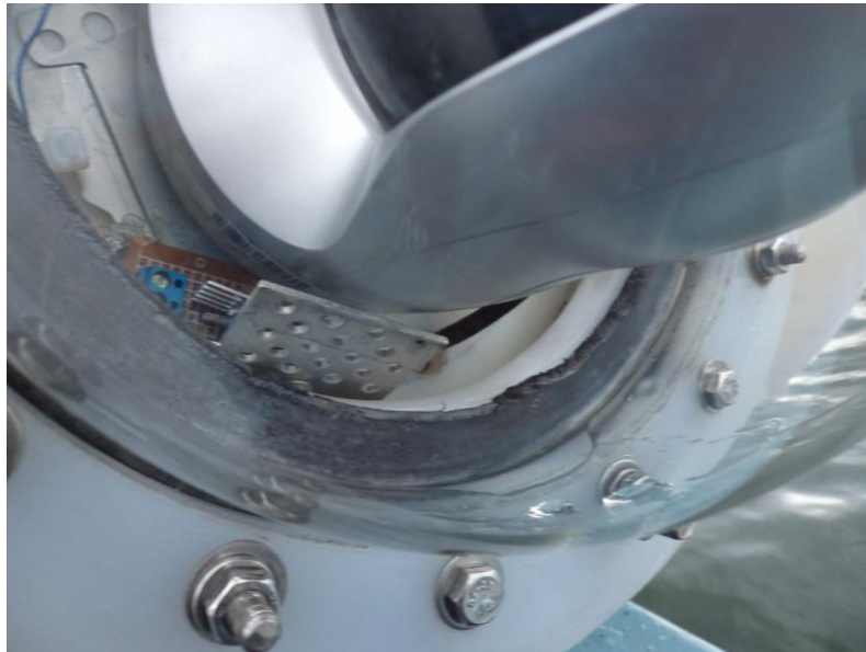
Figura 5.6-3 Hermeticidad de Equipos eléctricos.
