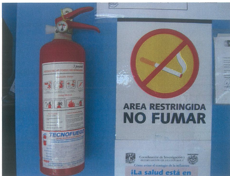
Anexo 21. Implementación de equipos de incendios y señalectica en medicina preventiva.(toma fotografica propia mayo del 2009)
