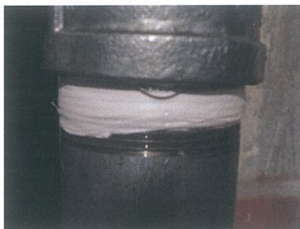
Figura 4.6: Filtración de agua por las uniones
