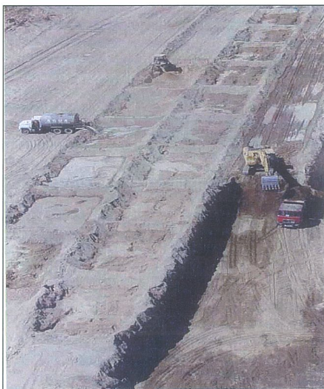
Figura 1.17. Piscinas de precondicionamiento (Nuevo Aeropuerto de Quito).
