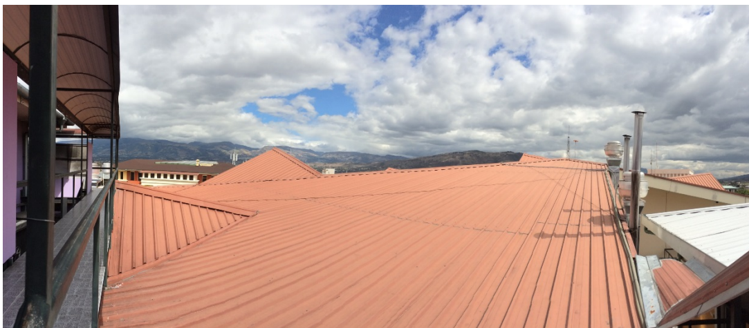
Imagen No. 47.- Vista de los techos de la universidad escogidos por la empresa Provientos.
