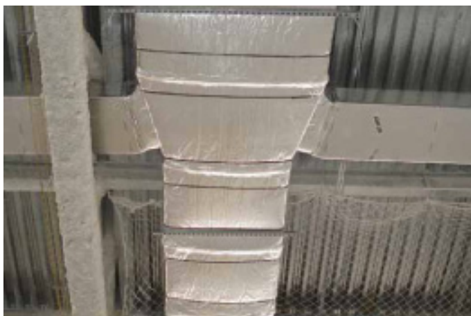
Imagen No. 13.- Ductos de ventilación aislados.
