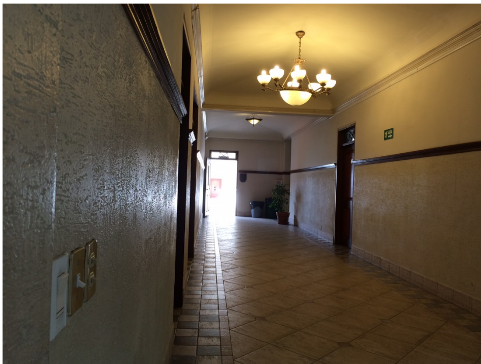
Imagen No. 39.- Interruptores en los que se puede poner temporizadores o sensores para evitar que las luminarias encendidas en la fotografía, permanezcan así a pesar de no haber nadie presente.
