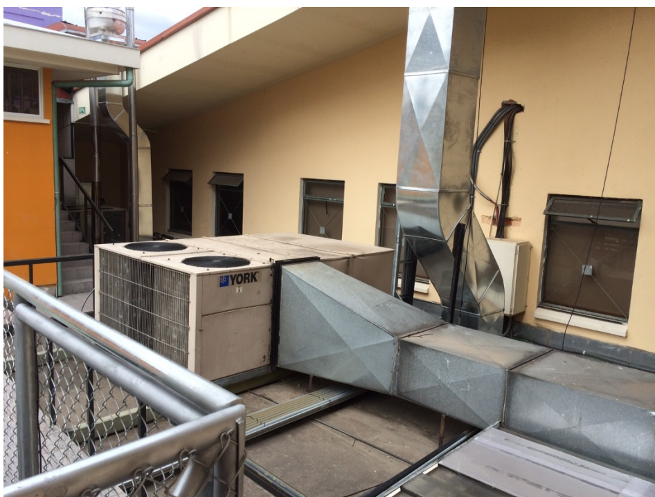
Imagen No. 16.- Unidades de aire acondicionado y ductos de ventilación sin aislantes. Ventanas del 2do piso de la Biblioteca.
