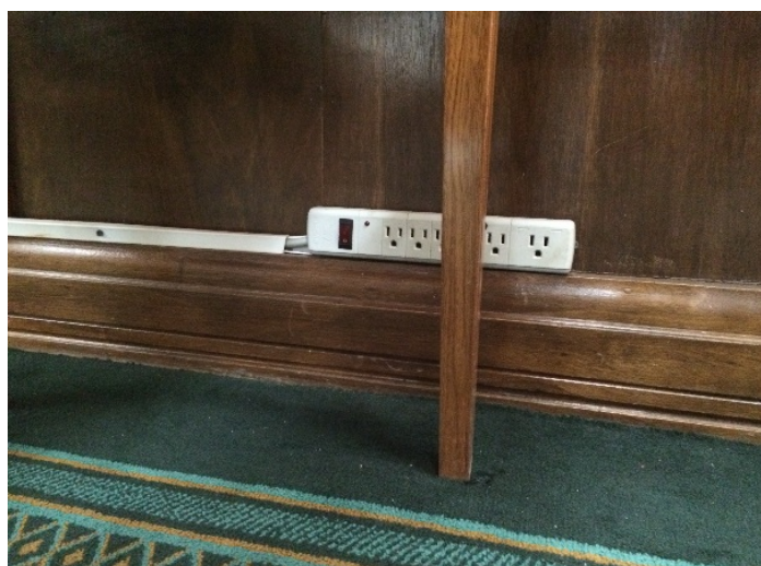
Imagen No. 6.- Regleta apagada. Biblioteca 2do piso.
