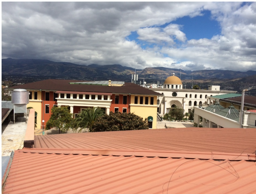
Imagen No. 46.- Vista de los techos de la universidad escogidos por la empresa Provientos. Techos de la biblioteca.
