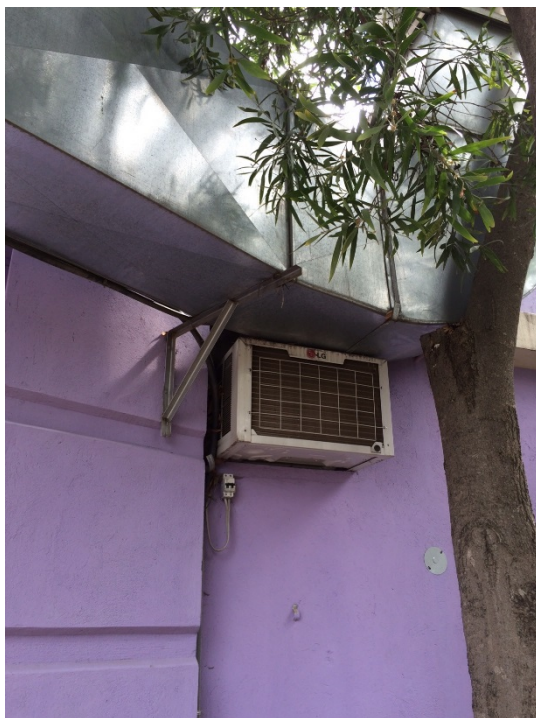
Imagen No. 15.- Ducto de ventilación sin aislante en contacto directo con una unidad de aire acondicionado.
