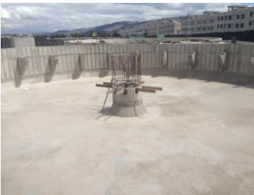
Foto 8 Sedimentación Secundaria. Elaboración propia
