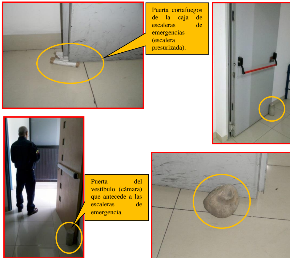
Fotografía 25. Estado de puertas cortafuegos en gradas de emergencia
