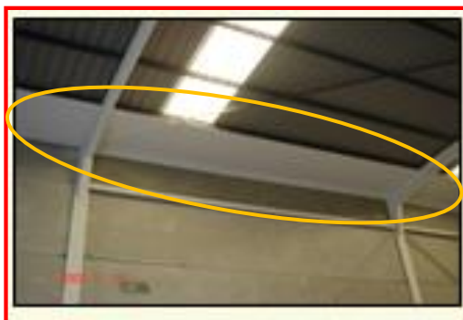
Fotografía 14. Franja, encuentro de medianera - cubierta
