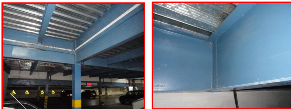
Fotografía 1. Columnas y vigas metálicas sin recubrimiento
