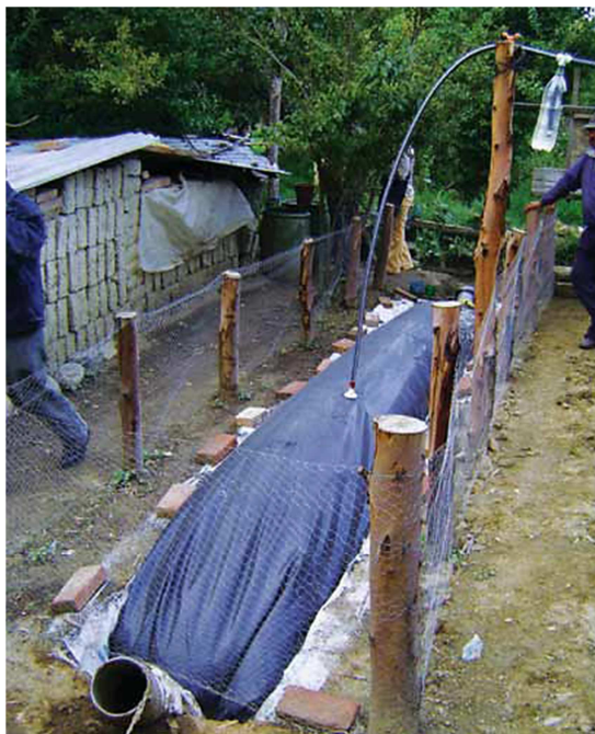
Figura 3.3 Instalación en zona tropical con cerca de protección
