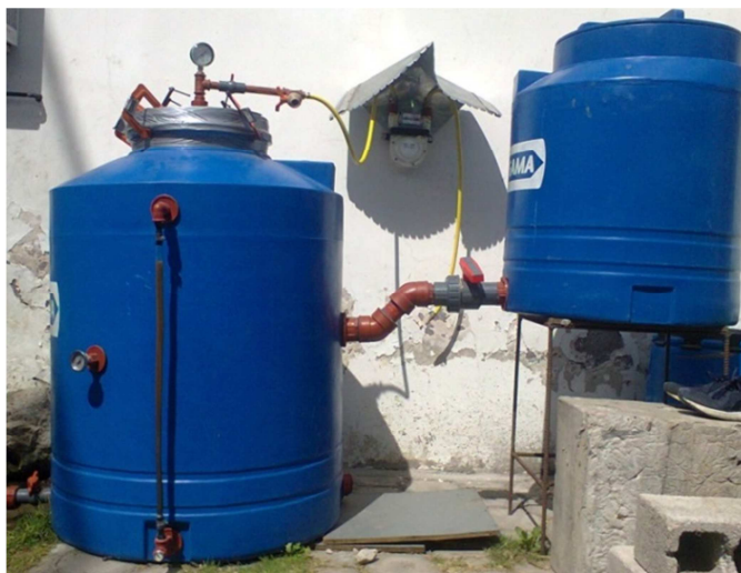
Figura 4.6 Nivel de trabajo del digester logrado
