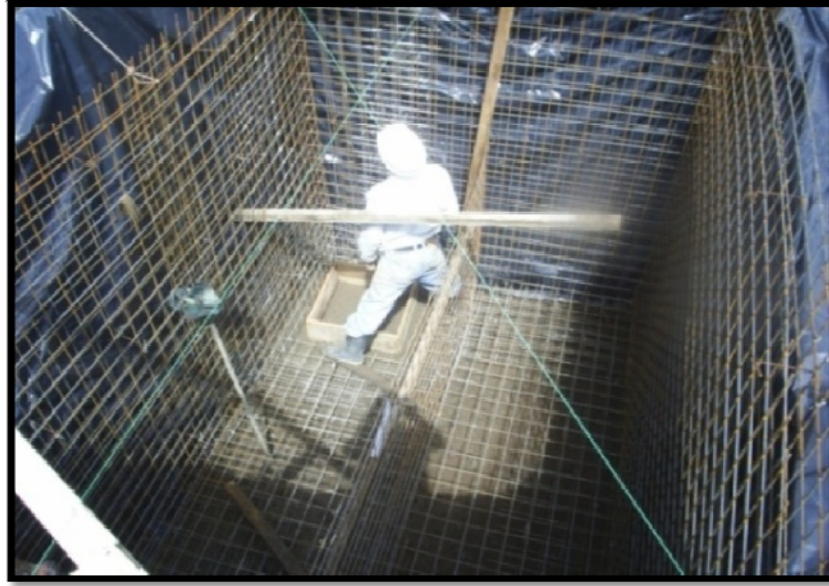
Fotografía 3 – Estructura de hormigón reforzado separador agua / aceite del Simulador (ADC&HAS, 2006)
