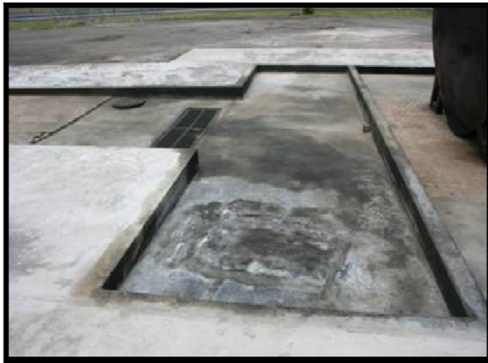
Fotografía 8 – Canal de recolección de efluentes de la plataforma del Simulador hacia el separador agua / aceite (ADC&HAS, 2006)
