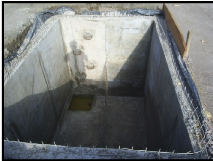
Fotografía 4 – Separador agua /aceite del Simulador (ADC&HAS, 2006)
